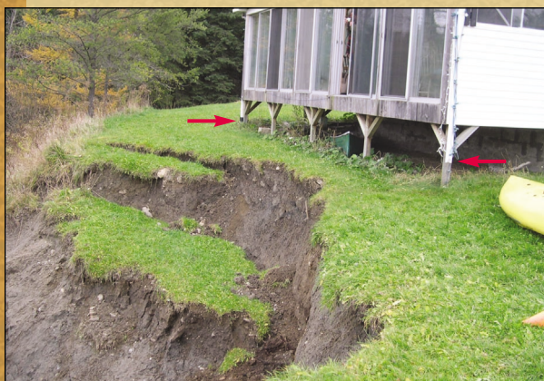
Gouttières (flèches) non raccordées à un tuyau allant jusqu'à la base du talus ou à un égout pluvial
