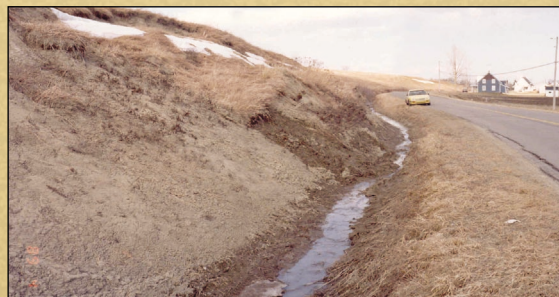
Excavation à la base d'un talus ayant provoqué un glissement
