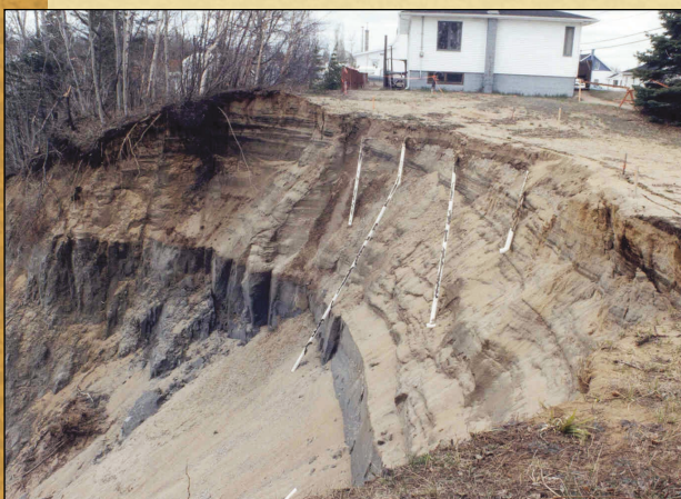
Champ d'épuration situé trop près du sommet d'un talus
